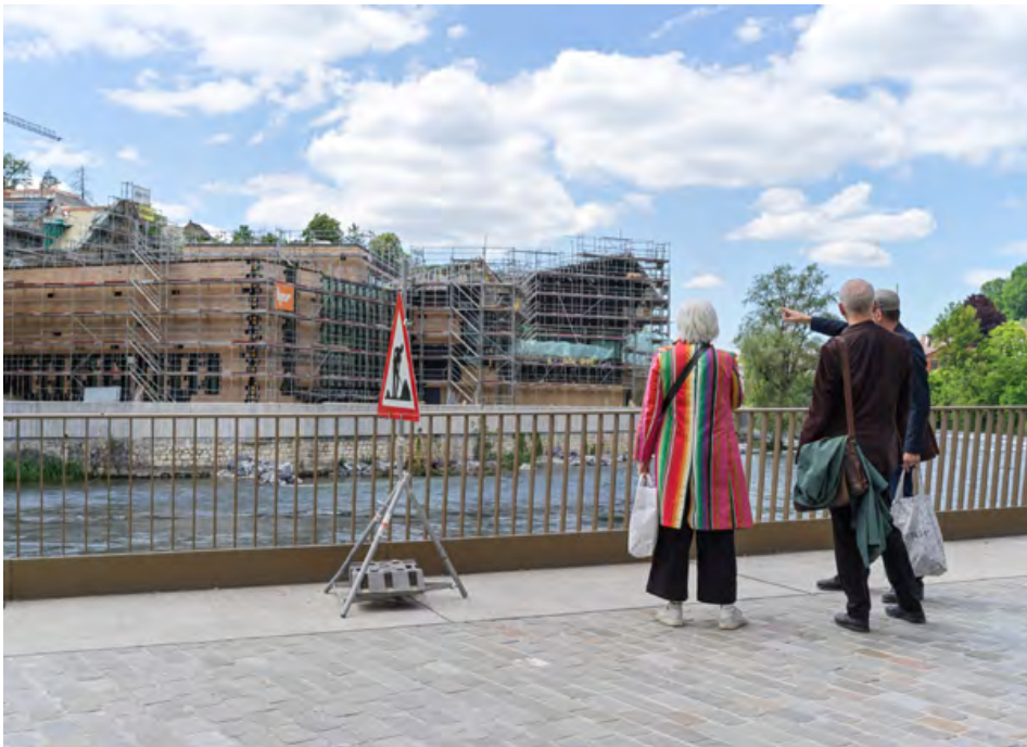
Les nouveaux bâtiments dans le quartier des bains suscitent des discussions. Photo: Björn Siegrist.
